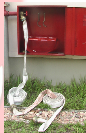
Foto 1 – Mangueira conectada de modo errado.
